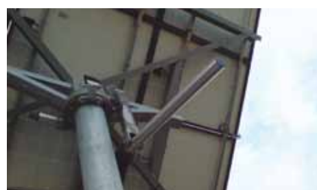
Un'ispezione dal retro mostra che non ci sono punti caldi; i punti caldi nell'immagine ad infrarossi precedente presa dalla parte anteriore erano causati dai riflessi.
